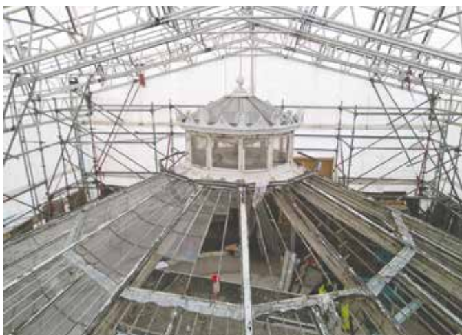
Drivhuset er igennem tiden repareret med moderne floatglas og silikone
