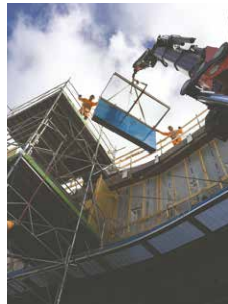
Toplement løftes op og gøres klar til montering. Bemærk at glastaget, allerede er monteret på elementet.
