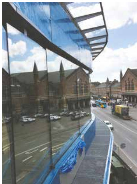
Den indvendige facade med plane trelagsruder er monteret. Efterfølgende monteres de buede ruder i den udvendige facade.
