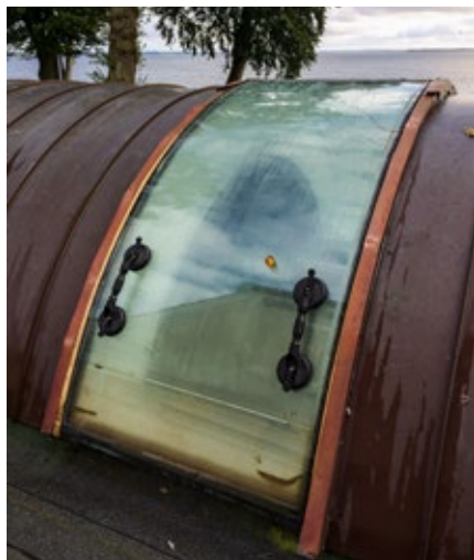
Den gamle rude var revnet og fyldt med vand.
