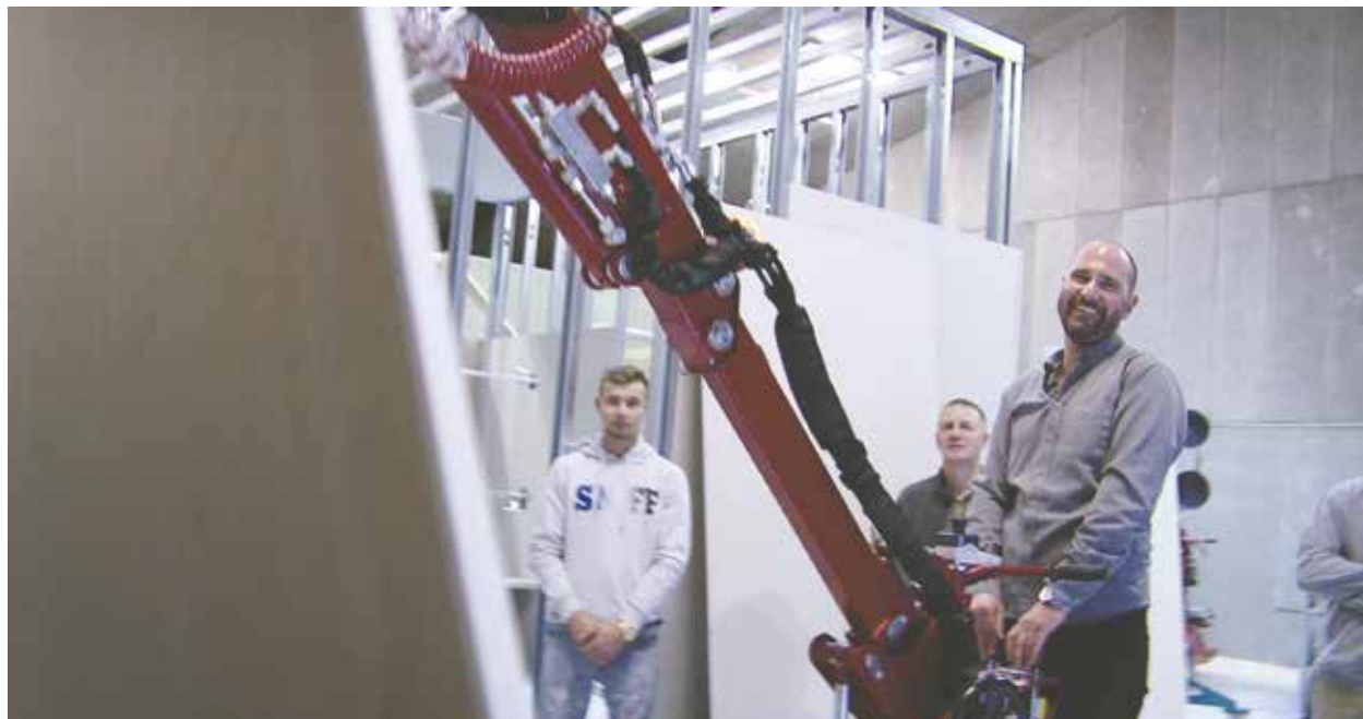
GLG's nye træningscenter i Fredericia.: Instruktør Peter Christensen fra Global Lift Group viser en gruppe tømrere, hvordan man kan montere gipsplader i højden.
