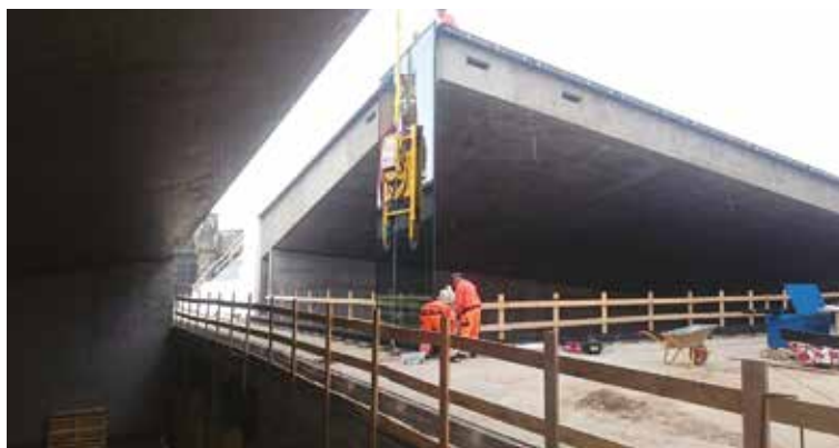
Montørerne er i gang med at montere et af de 6,4m høje og 1500kg tunge glas.
