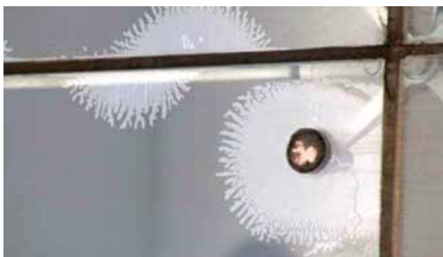
Skade på laminatfolie omkring fastgørelse. Misfarvning ses tydeligt uden, at her endnu er tale om delaminering. Eksempel fra Kuraray.
