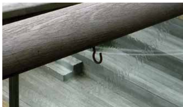
Værnglas, som delaminerer på grund af indtrængende fugt. Eksempel hentet fra Glasfakta.
