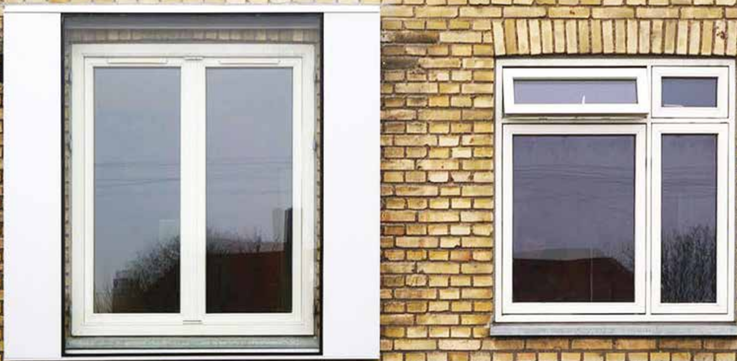
Et effektivt isoleringsprojekt mod trafikstøj er udført af Art Andersen & Co. ved den stærkt befærdede trafikåre Folehaven i Valby.
