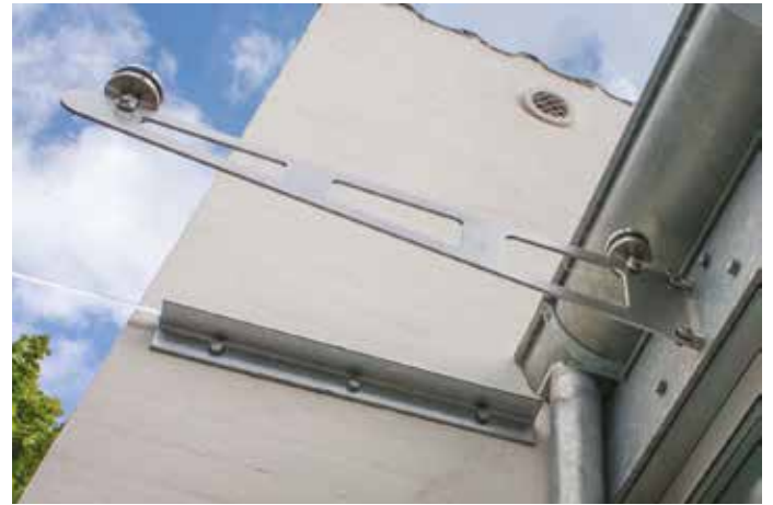
Glasset er CNC skåret i det hjørne hvor nedløbsrøret når ned. De bærende beslag er fra C.R. Laurence med 2 x 2 mm neoprenskiver mellem glas og beslag. I alt 6 beslag holder glasbaldakinen. Foto: Linette Bekhøi
