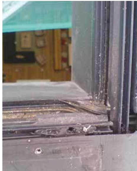
Utæt hjørnesamling. Saneres med nye lister og tætning med Schüco Flex.
