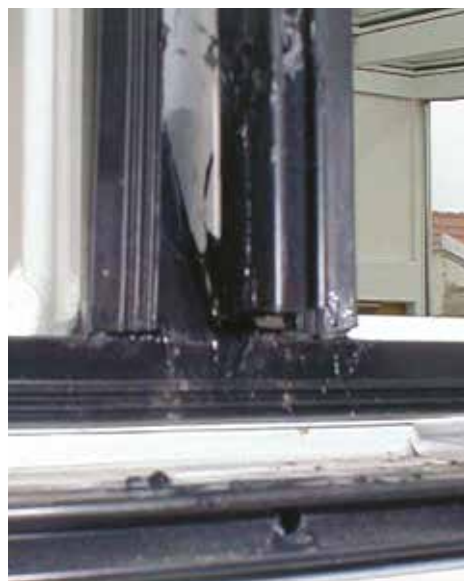
Utæt tvær- og lodpostsamling. Saneres med komplet tætning med Schüco Flex 2.
