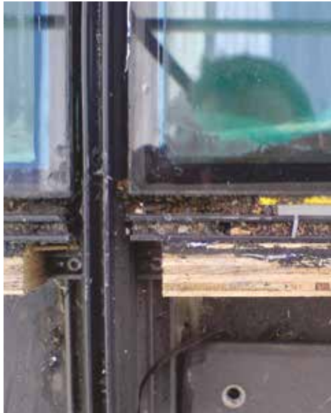
Utæt hjørnesamling. Saneres ved rengøring, nye lister og tætning med Schüco Flex og brug af korrekte materialer.
